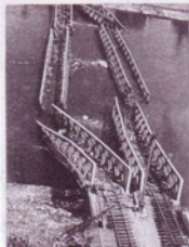
Diese Eisenbahnbrücke ist ohne Zweifel von Fachleuten geprengt worden. Die Zerstörung ist nachahmbar, für unsere Pioniere aber nicht unüberwindlich.
